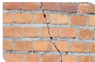
Trinca em alvenaria.
