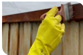
Aplicação em portão.
